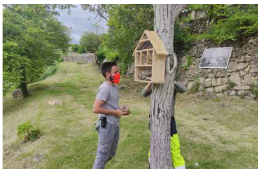
Fabrication de la structure des hôtels à insecte et mise en place
