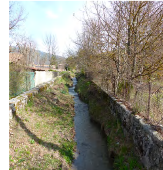
La digue sur le Verdon et ruisseau canalisé permettant de limiter la divagation de ces cours d'eau lors des crues
